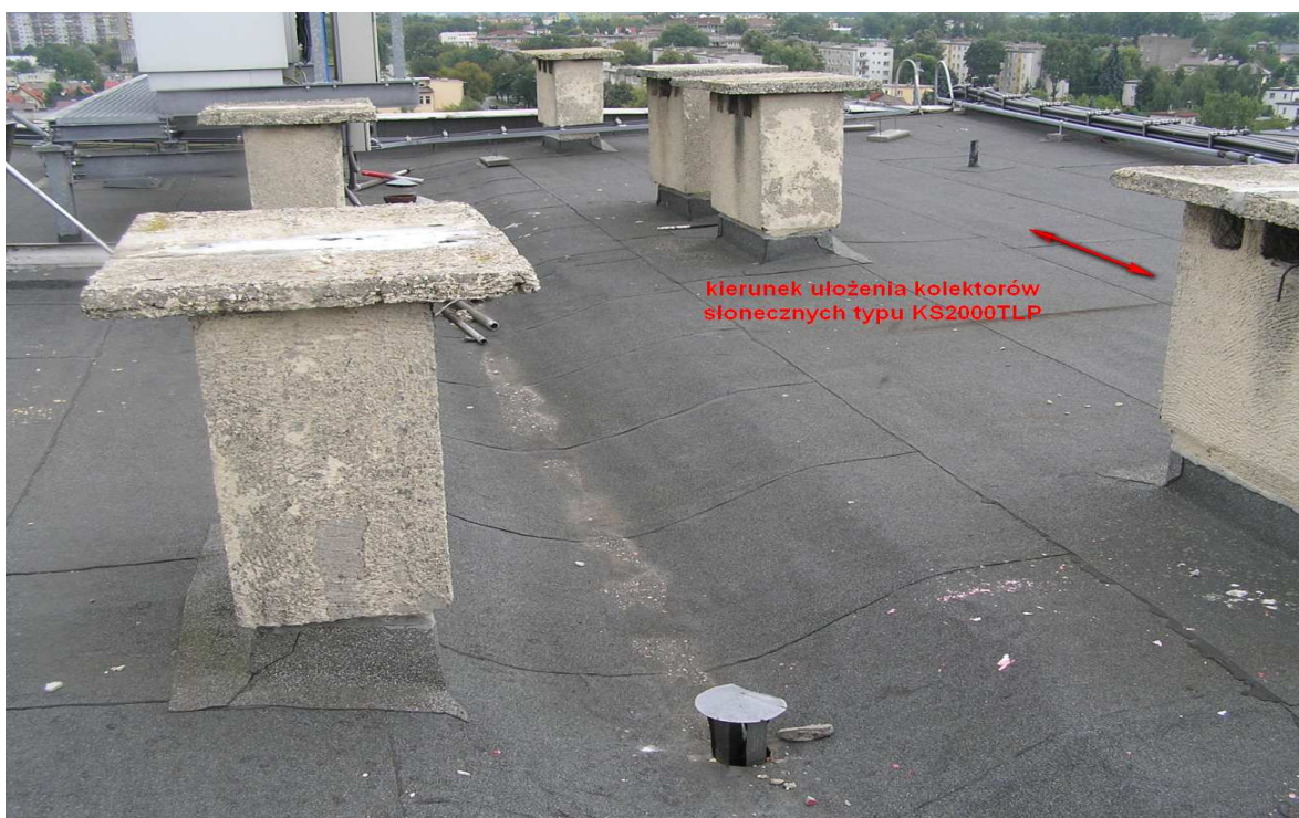
Fot.4. Widok rozmieszczenia kominów wentylacyjnych. Kierunek ułożenia zestawu kolektorów słonecznych.
