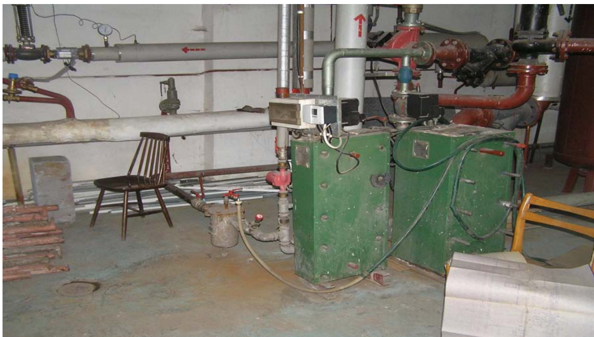
Fot.9. Widok wymiennikowni zlokalizowanej w przyziemiu budynku – miejsce lokalizacji montażu zbiorników VF500-2 o pojemności 500 litrów.
