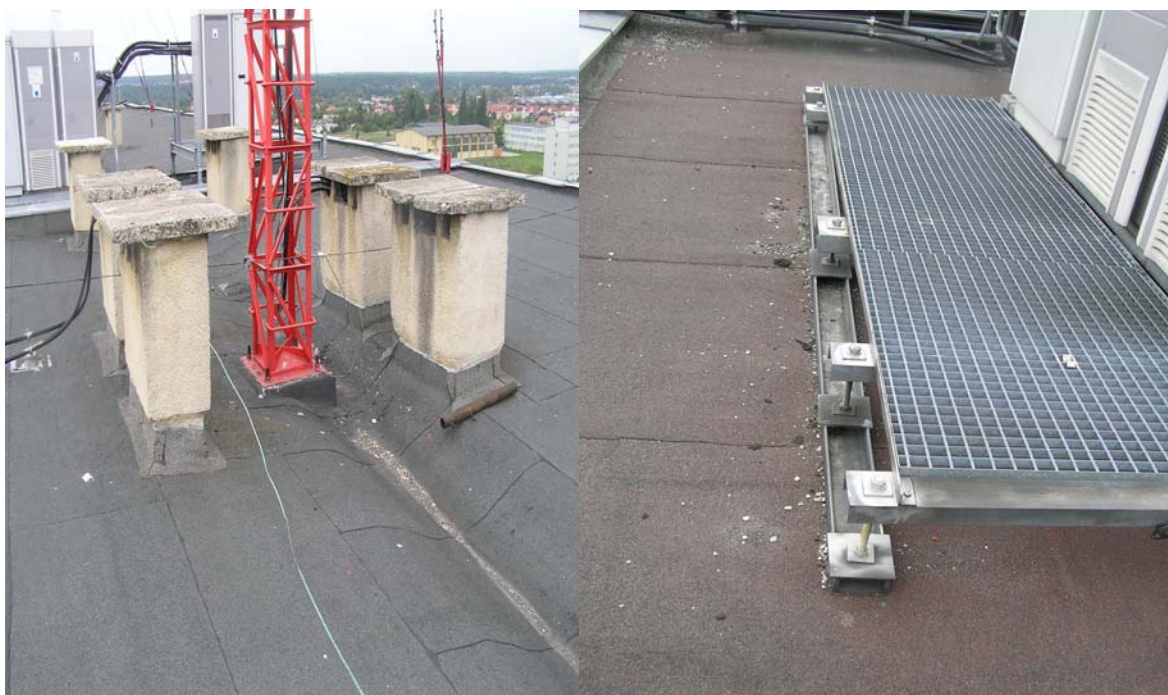
Fot.7, Fot.8. Widok sposobu montażu istniejących urządzeń na stropodachu. Ciężar central został równomiernie rozłożony za pomocą profili na prefabrykowane płyty panwiowe Fot.8.
