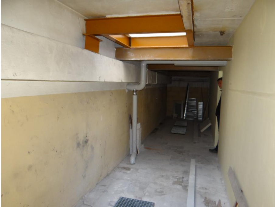
Fot. 5. Piętro IX- widok na maszynownię, widok na instalację hydrantową do ukrycia w zabudowie z lekkiej zabudowy gips-kartonowej REI 120.
